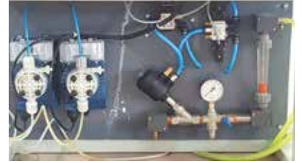
Sıvı Dozaj Pompası
